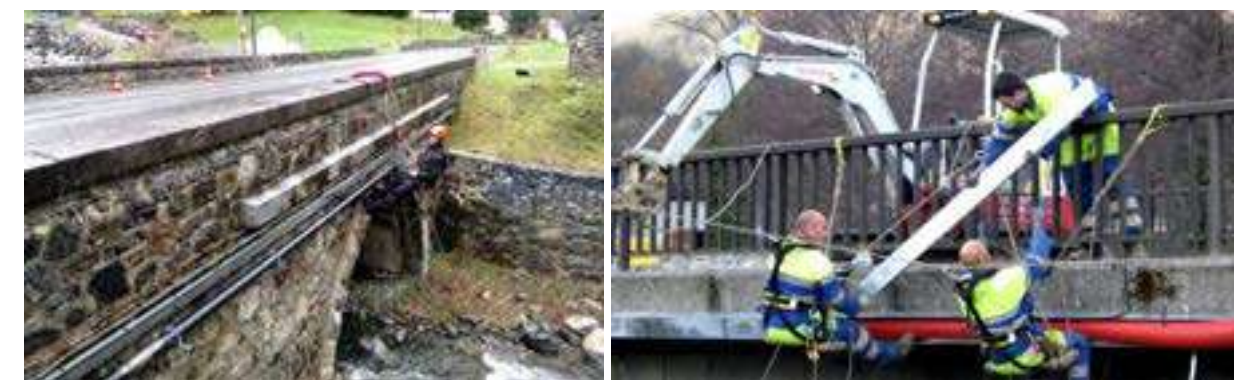
Figure 118 : Exemple de passage de câbles par encorbellement sur les ponts (Sources : 2 Cordes à cordes et la dépêche)
