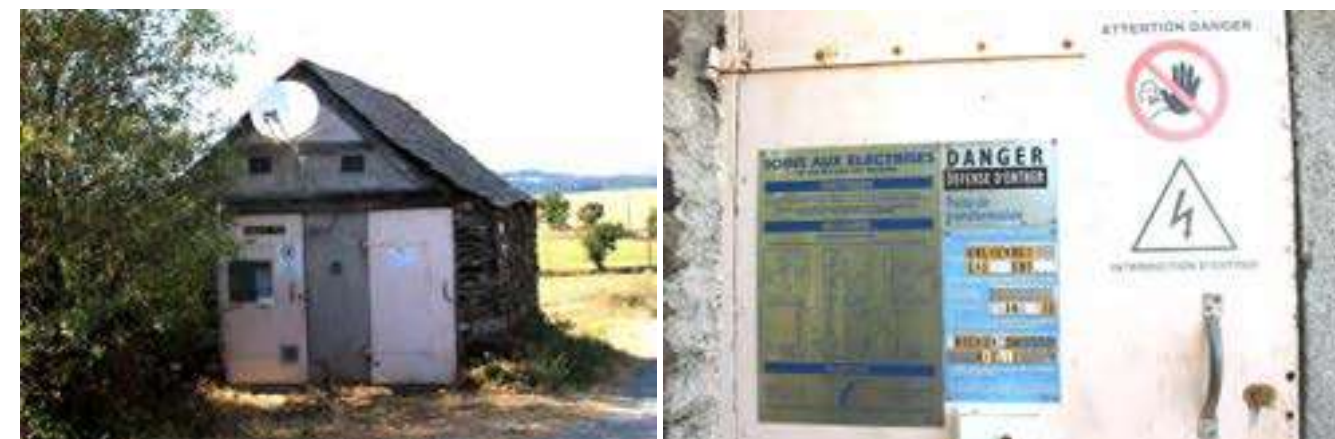
Photo 31 : Le poste de transformation de la centrale éolienne de Lascombes
