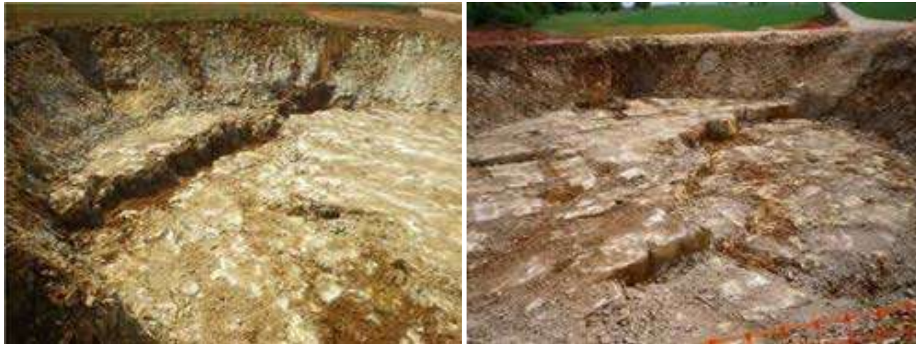
Figure 43 : Exemples d'anomalies détectées après l'excavation qui ont nécessité une consolidation du fond de fouille avant la réalisation de la fondation superficielle
